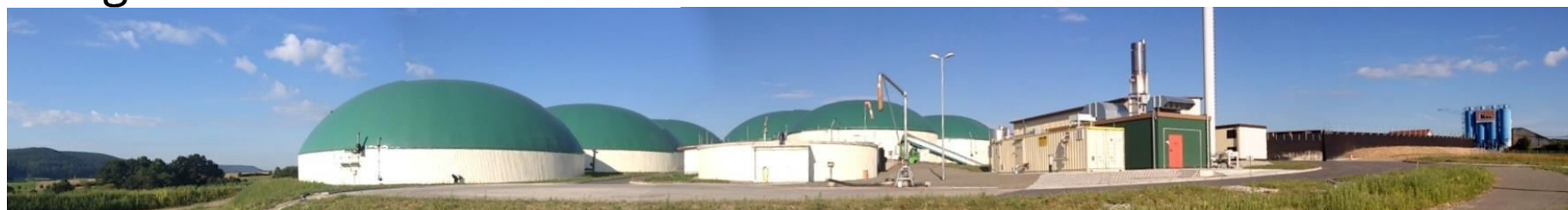
Biogasanlage Rippershausen (1.216 kW el, 2 Satelliten-BHKW, 6,5 km Gasleitung)
